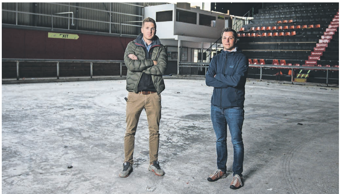
Auf der Betonplatte. Nicolas Zenklusen (links) und Bruno Umericelli begleiten die Abbrucharbeiten in der Litternahalle.
